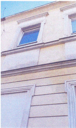
Trhlina přes celý objekt
